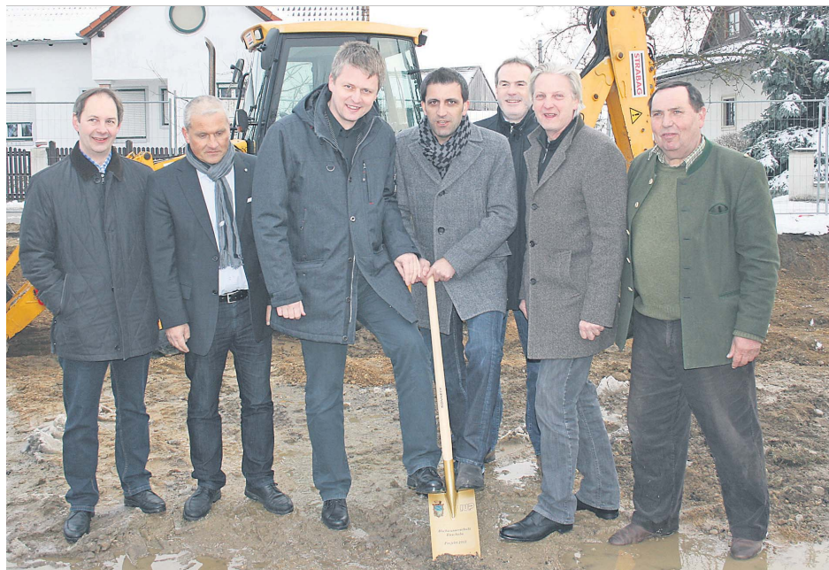
Thomas Bauer, Christian Lausch, Günther Schnötzing, Erwin Bernreiter, Josef Keck, Alfred Babinsky und Ortsvorsteher Franz Satzinger (v.l.) eröffnen offiziell den Brücken-Abriss in Raschala. Fotos: Frank
